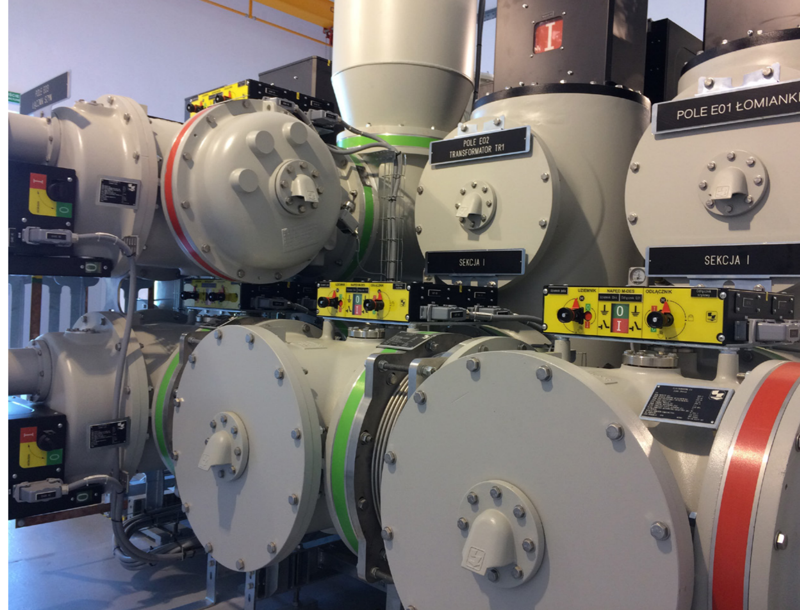
PGE Dystrybucja, Nowoczesna rozdzielnica 110 kV w technologii GIS w układzie H5, zabudowana w GPZ 110/15 Czosnów
