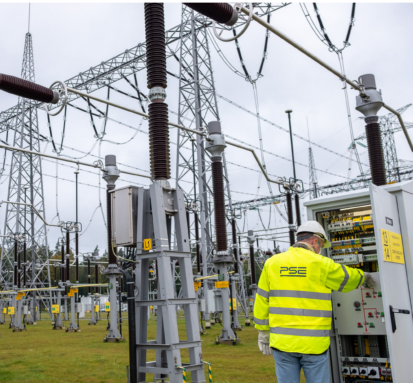
PSE, Szybka i selektywna eliminacja zakłóceń stanowi kluczowy element gwarantujący bezpieczeństwo personelu obsługującego obiekty Operatora Systemu Przesyłowego
