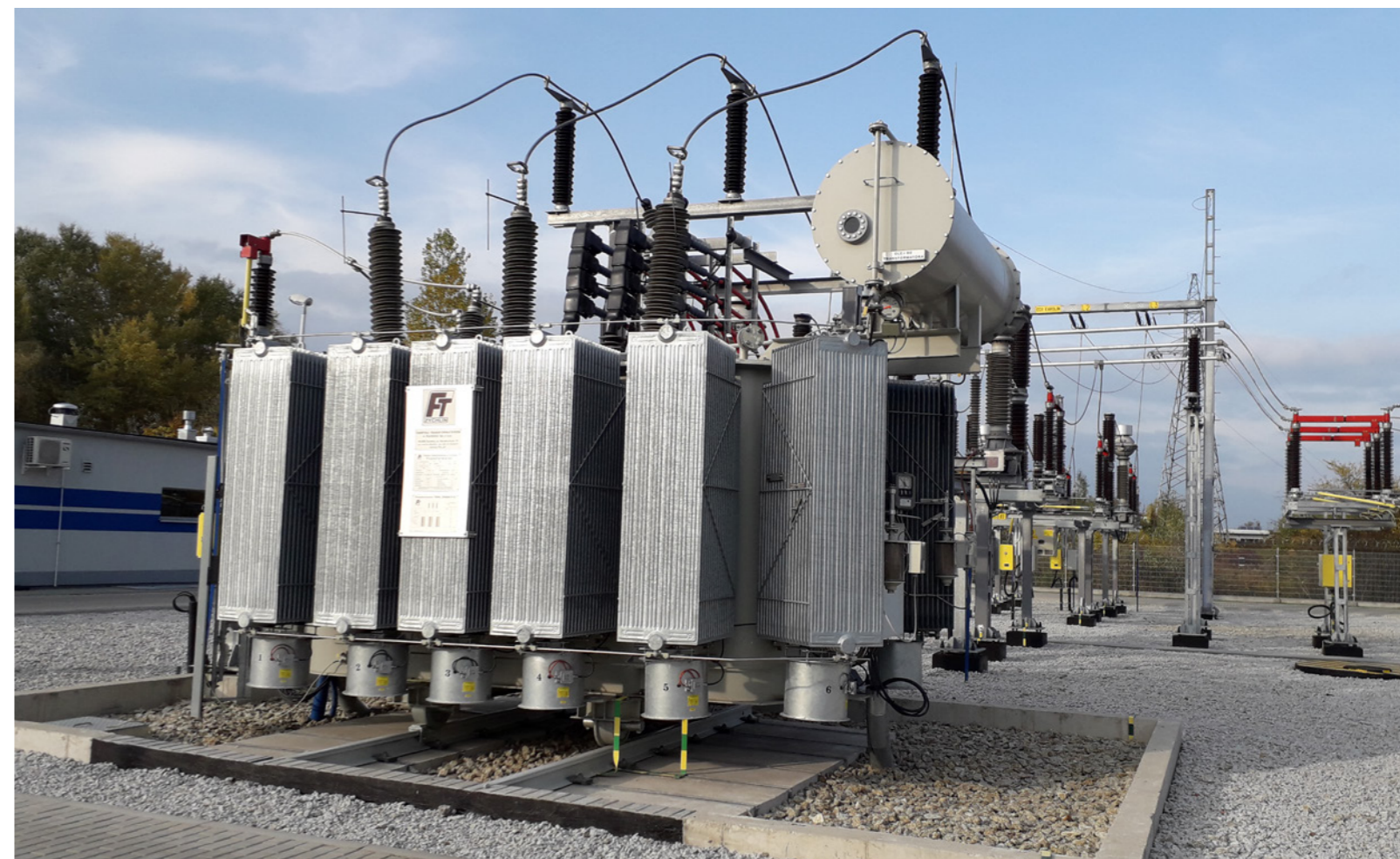
Enea Operator, GPZ Główna w Poznaniu
